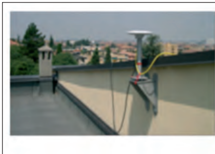
Fig. 6 - Stazione permanente GPS
