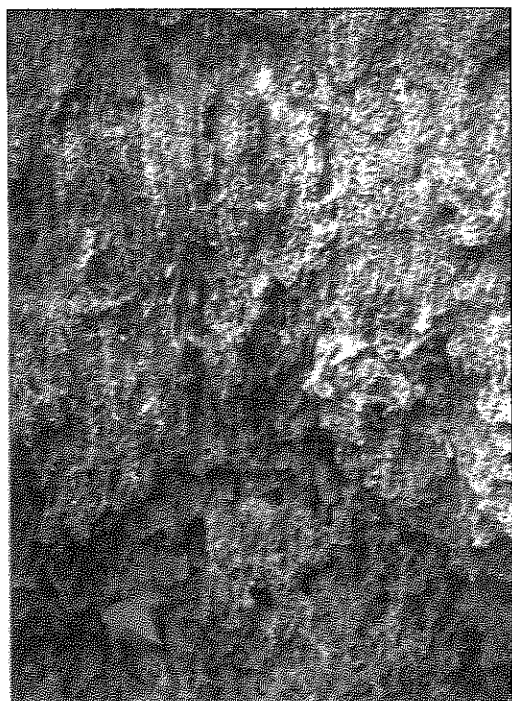
FIGURA 10 – Particolare del travertino, lungo il sentiero della Specola, caratterizzato dall' elevata porosità indotta dalle incrostazioni sulle piante igrofile.
