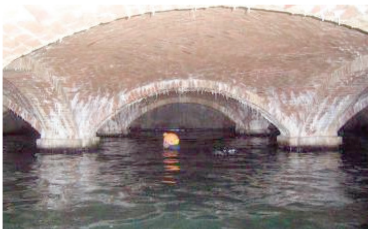
Fig. 10 La cisterna d'acqua sotterranea presente sotto il parcheggio adiacente alla scuola elementare ripresa durante la sua ispezione
