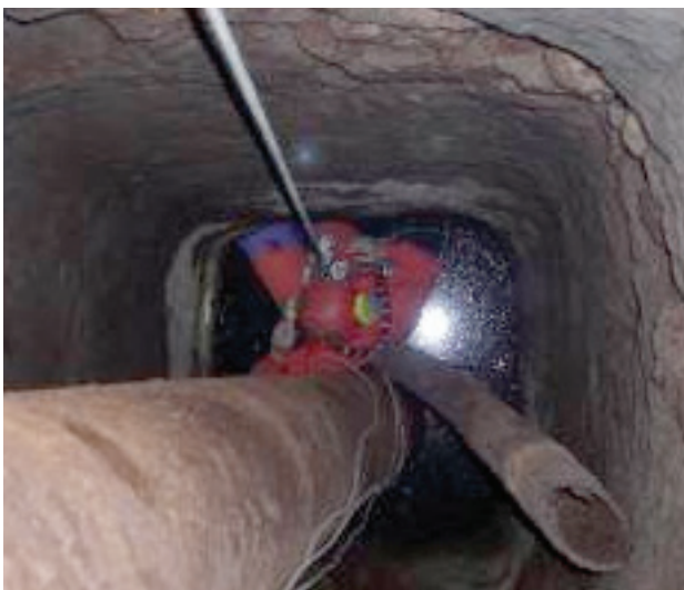
Fig. 4 L'inizio della porzione allagata ed una tubazione rotta
