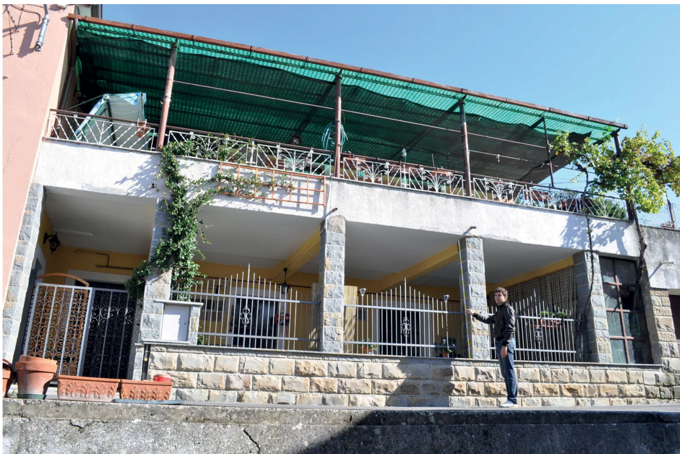
Esempio di costruzione incoerente sia nei materiali (pietre diverse al piano terra, intonaco, ferro e ondulina al piano primo) sia nelle forme (si osservino le recinzioni al piano terra, diverse nelle linee dal portoncino di ingresso, e diverse dal parapetto al livello superiore).
