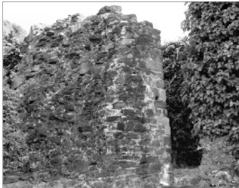
Fig. 18. Struttura muraria (terrazzamento?) sottostante il lato settentrionale della basilica civile a San Giusto.
