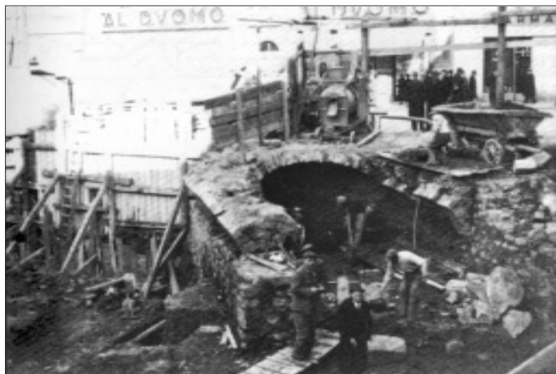
Fig. 8. I resti del ponte a due arcate in Corso Italia (da GRILLI, MENG 1978-1979).
